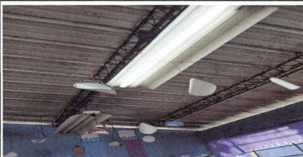
Foto 5: alumbrado electrico en las aulas
